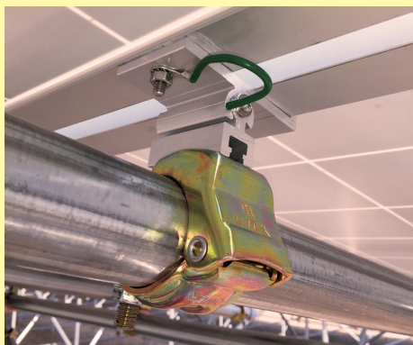
縦通しタイプアース状況
